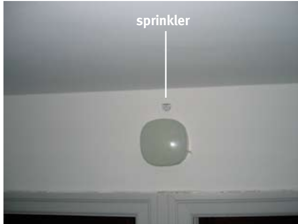
"Sidewall" sprinkleren i trapperummet fylder kun 15 x 15 millimeter.
